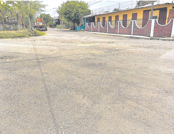
Problema. Las aguas grises se estancan sobre la avenida Nicaragua, afectando a automovilistas y residentes del sector.
